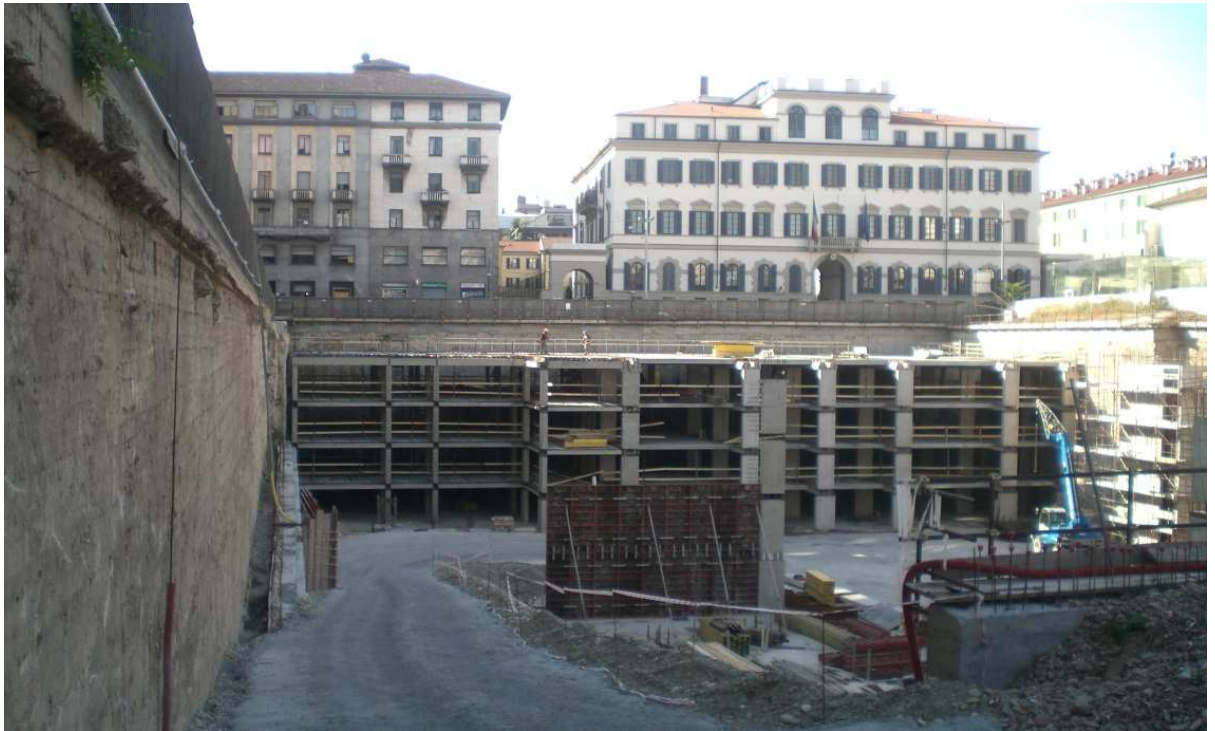
Foto – Vista cantiere da via Fatebene Sorelle. Strutture pluripiano parcheggio su platea continua a tenuta idraulica: in primo piano diaframmi continui di altezza H = 13.0 m.
